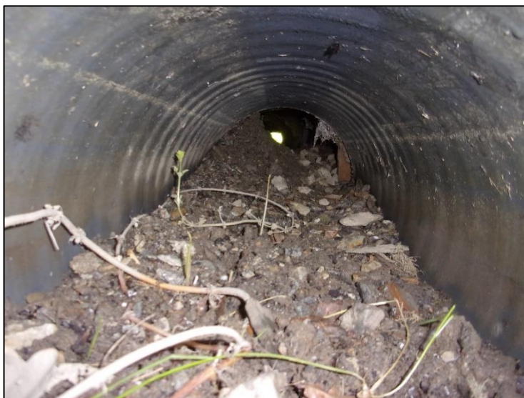
Photo 3 : Vue d'un réseau à curer – Réseau Ø300 de la route de Bréheuil
