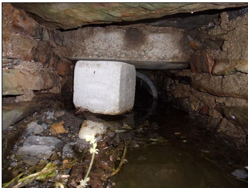
Photo 6 : Obstacle à l'écoulement – Traversée Ø400 de la Grande Rue
