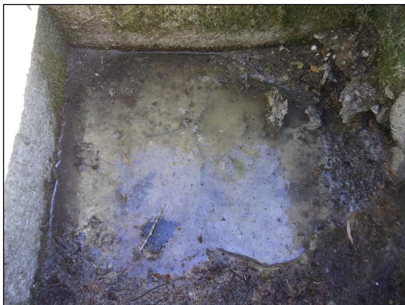
Photo 5 : Vue d'un mauvais rejet
