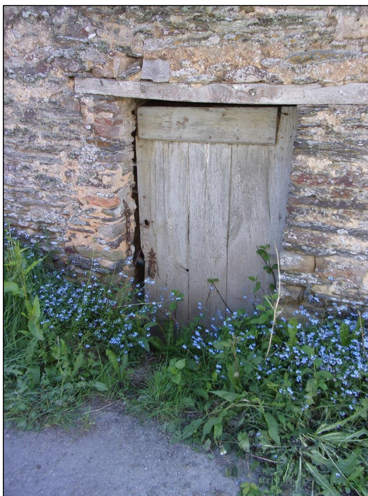
Vue de l'entrée de l'habitation située en bordure de la rue de la Bimais
