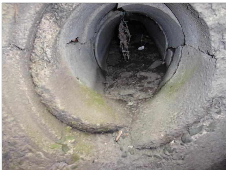
Photo 7 : Curage + réseau fissuré – Réseau Ø300 de la rue de la Bimais
